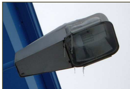
Bild 1: SL-30W am Hauptgebäude
